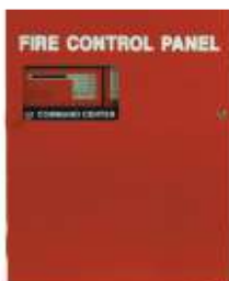
Figura 2 : Central alarmi zjarri konvencional
